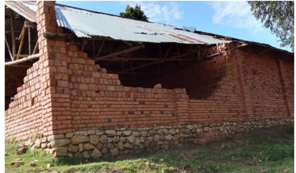
Das durch Unwetter schwer beschädigte Gebäude der Schule Institut Mt. Tshiabirimu © Kasereka Gervais
