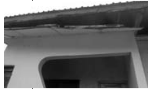
Das marode Hauptquartier des Afi-Reservats zum Schutz der Cross-River-Gorillas, das nun mit unserer Hilfe renoviert wird Foto: WCS Nigeria
